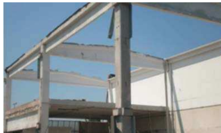
Perdita di appoggio dei pannelli di copertura
