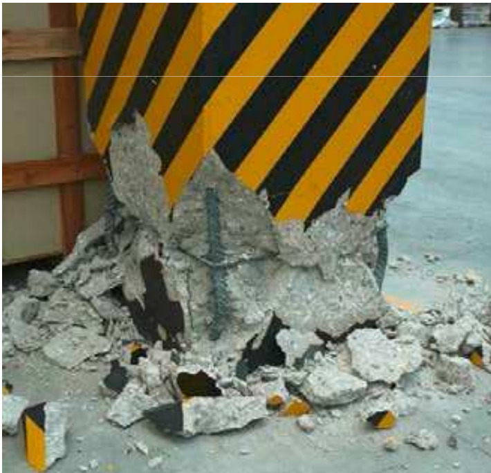
Cerniera plastica alla base del pilastro
