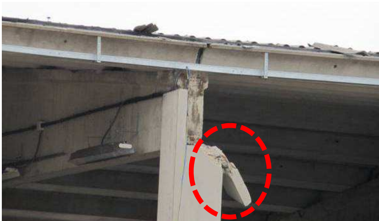
Insufficiente resistenza della forcella
