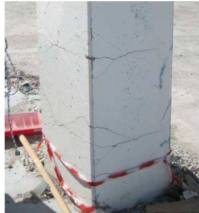
Fessurazione alla base del pilastro
